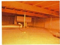
床下に設置したエアコン（暖房用）。安価なインシャルコストで全館暖房を実現。
