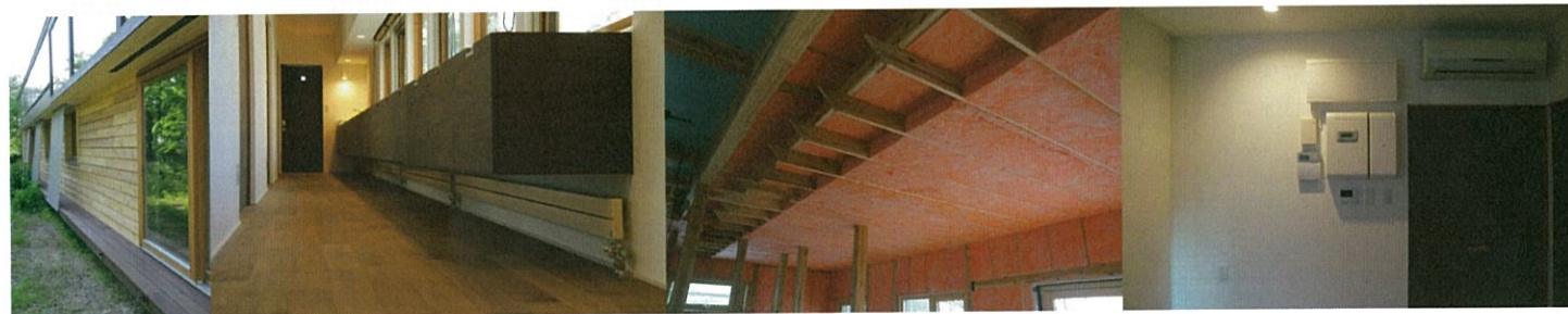
③外付ロールスクリーンや庇は夏場の日射遮熱に有効。断熱に加えて遮熱は大幅な熱負荷削減につながる。 ④温水パネルヒーターは音や風が発生せず、静穏な室内温度環境となる。 ⑤Q値 0.84W/㎡K の性能値は屋根HGW450mm、壁HGW240mmというハイスペックが生み出している。 ⑥設備のコントローラー群。太陽集熱を基本としたバックアップシステムを確立している。
